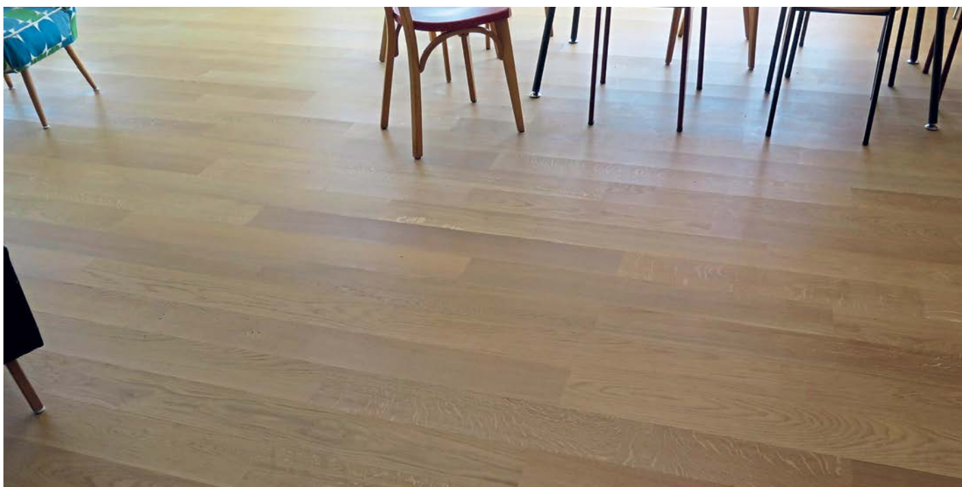
Intensive konkave Verformungen des Massivparketts.
