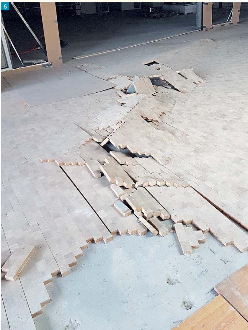
4 Ablösungen in alten Leimschichten und Spachtelmassen nach Renovationsarbeiten mit neuem Hirnholzparkett.
